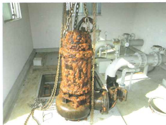
図4 真砂東揚水機場
