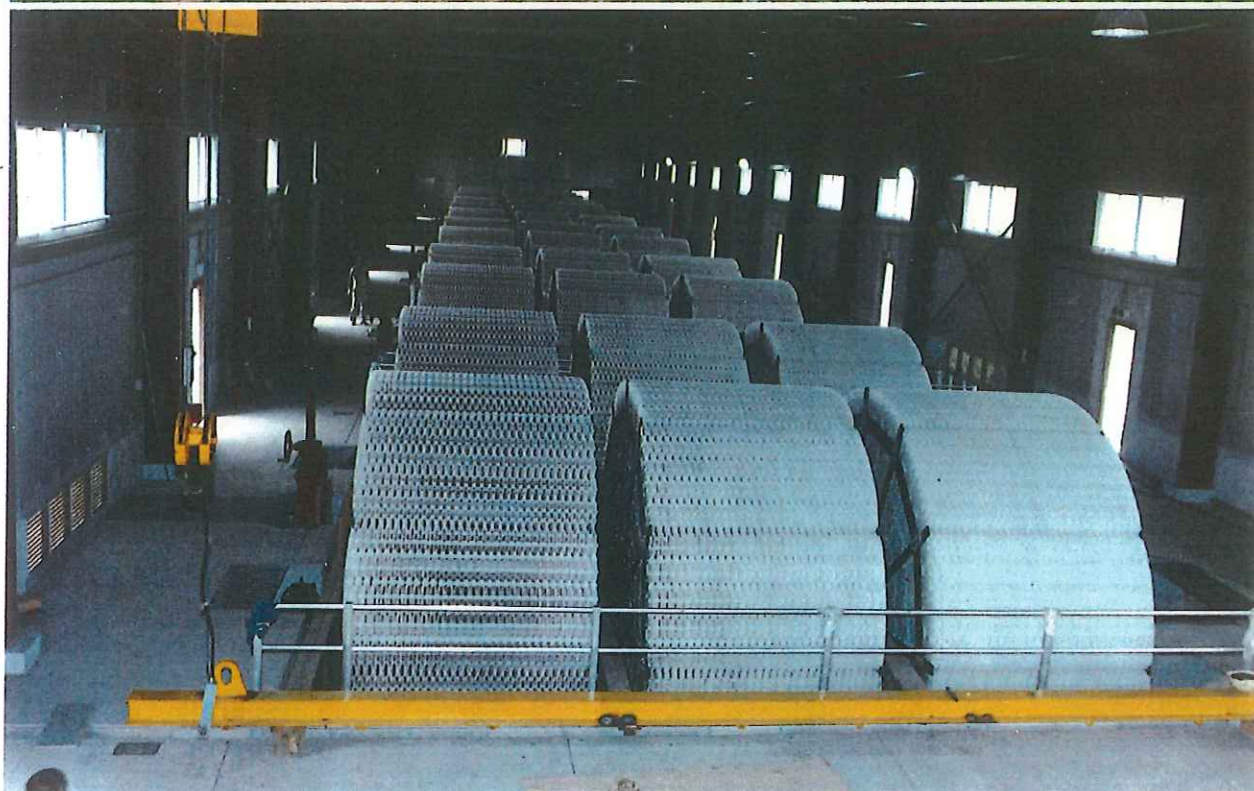
三ヶ牧浄水機場上屋と回転円板装置
