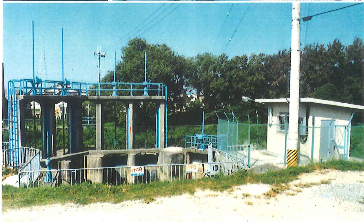
三ヶ牧ポンプ場より遠隔操作される別府子局のゲート等の施設
