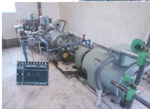
改修前の横軸斜流ポンプ
