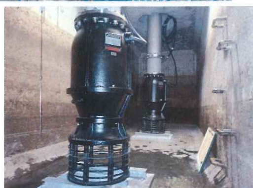
改修後の水中軸流ポンプ
