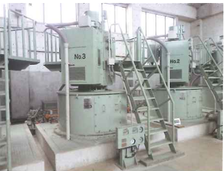
団体営9 三箇牧揚水機場 3号揚水ポンプ主電動機
